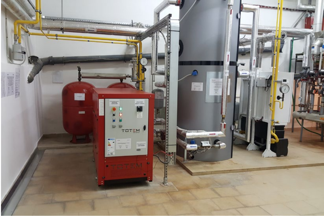
↑ Mikrokogenerační jednotka Totem spolu s akumulací nádrží pro teplou vodu v zázemí Budišova nad Budišovkou. Foto: Young4Energy
