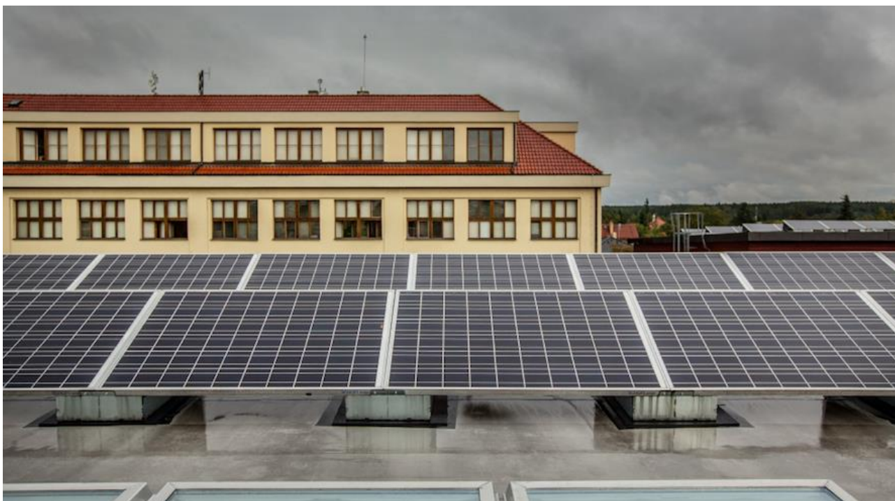
Obr. 6: Solární panely na ZŠ Kunratice (zdroj: AliES)
