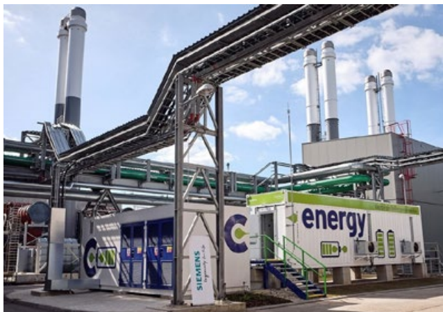
Strojovna plynových motorů Rolls-Royce v teplárně Planá nad Lužnicí, v popředí bateriové úložiště. Foto: C-Energy Planá
