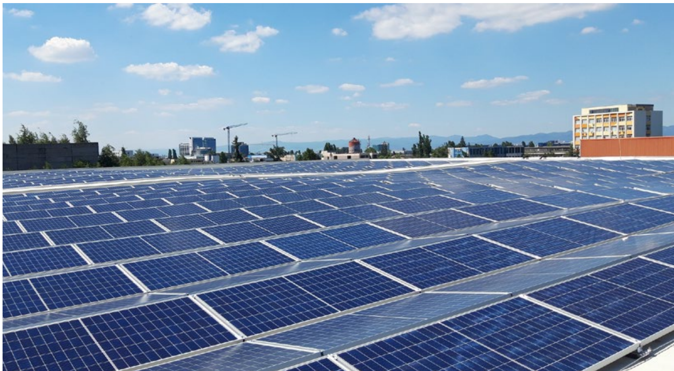
Střešní fotovoltaická elektrárna. Foto: ČEZ ESCO, a. s.
