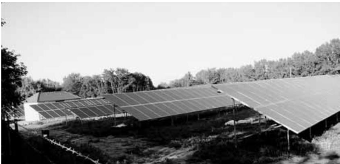
Obrázek 21 - Lužice: Obecní fotovoltaická elektrárna
