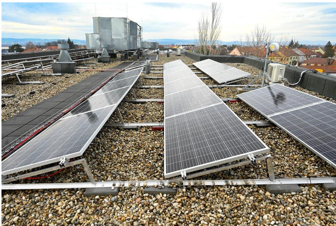
Obrázek 11 - Fotovoltaická elektrárna o výkonu 63 kWp na budově Domova pro seniory Holásecká v Brně. Zdroj: Město Brno
